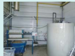
排水処理設備
