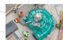
● 大深度下水設備 [シンガポール]
