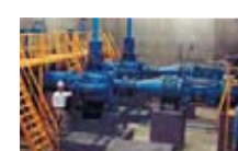
● 上水道設備 [スリランカ]
