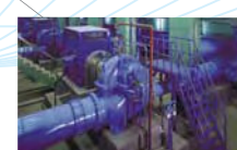
● 上水道設備 [インドネシア]
