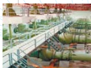
● 上水道設備 [マレーシア]
