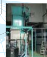
● 下水処理場 [中国] (実証施設)
