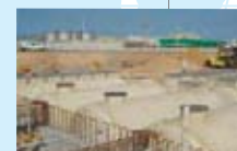
● 排水処理施設 [サウジアラビア]
