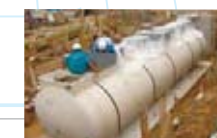
● 排水処理施設 [ベトナム]
