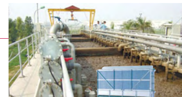
稼動中の排水処理施設
