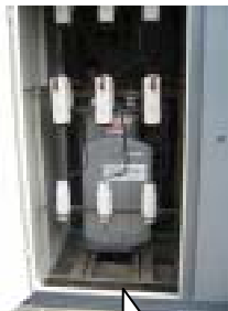
変圧器 設置状況
