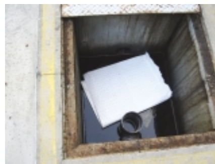
油水分離槽最終槽の浮上油はオイルマットで吸着させる
