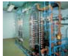
膜を使った中水道設備
