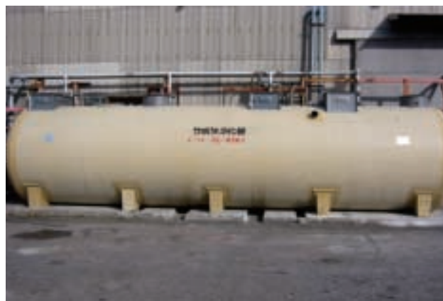
佐賀県 ホテル向け浄化槽 K-HC-R2タイプ 436人、88m 3 /日 （流量調整槽+汚泥濃縮貯留槽）
