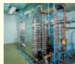
本社敷地内にある膜を使った中水道設備
