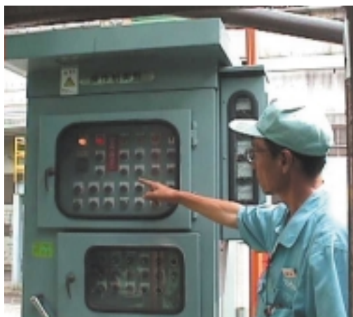
現場操作盤警報確認
