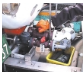
薬品(硫酸バンド)供給停止。 (給液バルブを閉める)
