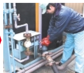
薬品タンクの給液バルブを閉める。
