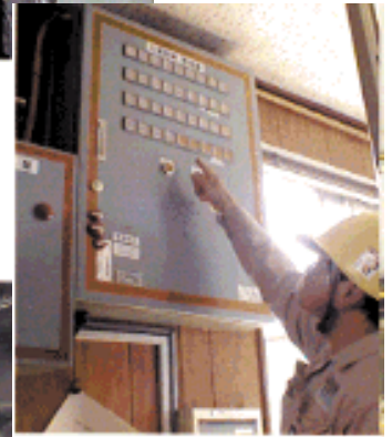
警報表示板確認(枚方製造所)
