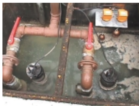
排水ポンプ2台化(内1台は緊急時対応用の予備)による故障時の排水オーバーフロー防止(堺製造所)
