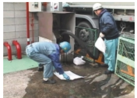
タンクローリーの重油受入時タンクローリー給油フランジ接続部よりの油洩れ対策訓練風景(堺製造所)
