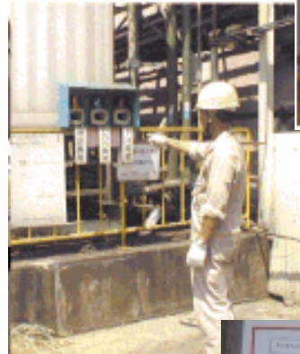
現場警報確認(枚方製造所)
