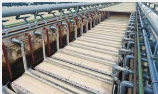
S市A水再生センター
