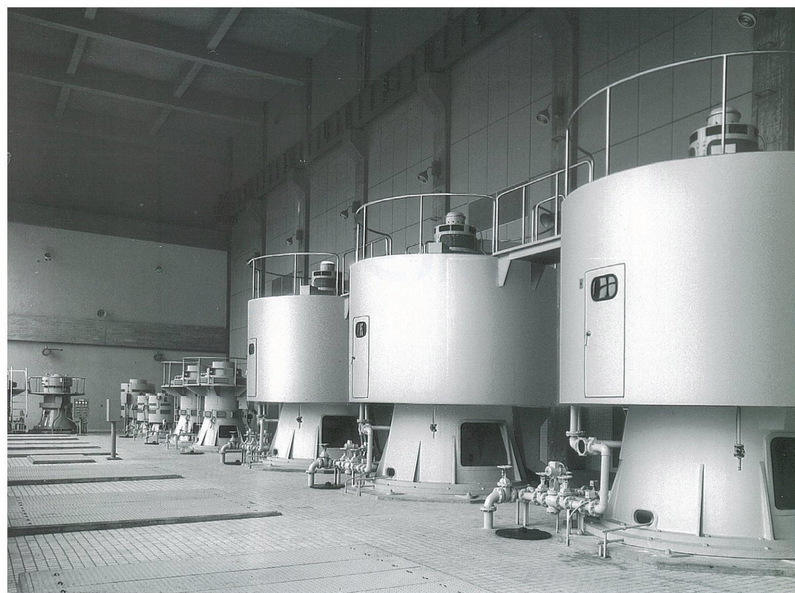
東京都水道局金町浄水場第5配水ポンプ場 1200mm×208m 3 /min×49m×495rpm×2200kw
