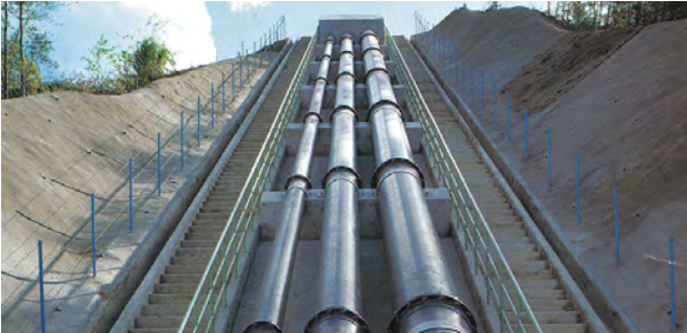
発電(傾斜地配管)
