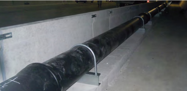
道路トンネル(消火配管)
