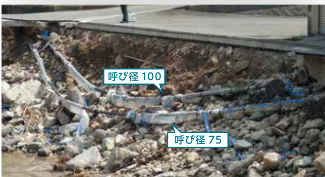
道路崩壊(台風被害、松山市)
