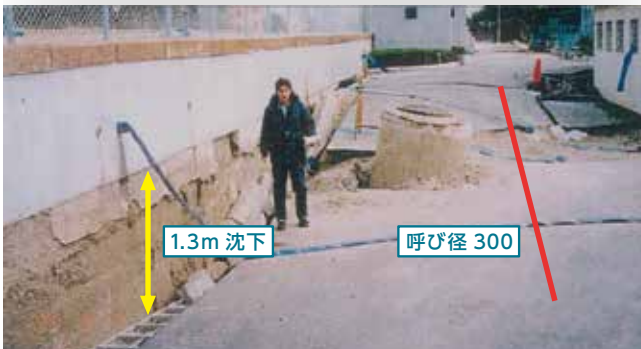
地盤沈下(阪神・淡路大震災、神戸市)
