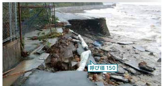
道路崩壊(台風被害、臼杵市)
