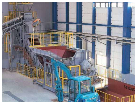
● 粗大ごみ資源化施設に設置されたPS2-1600H
