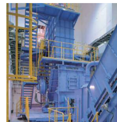
●粗大ごみ資源化施設に設置されたPS2-1600H
