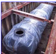
耐震・緊急用貯水槽
