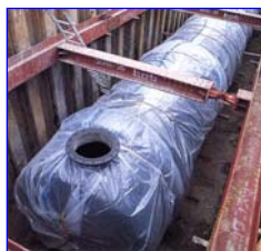
耐震・緊急用貯水槽
