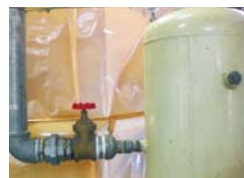
エア配管の大径化による省エネルギー活動
