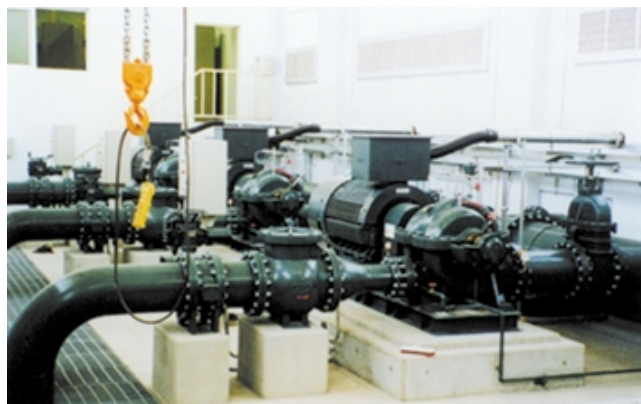
配水ポンプ設備
