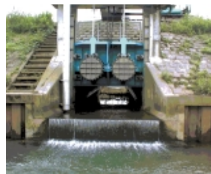
実機納入ポンプゲート
