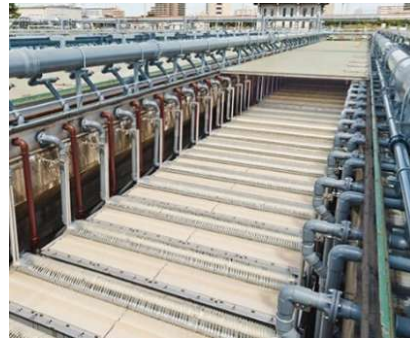
水処理プラント
