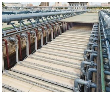
水処理プラント
