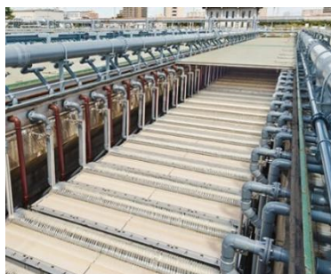
水処理プラント
