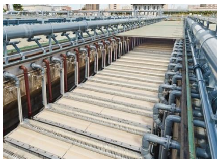
水処理プラント
