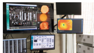
中央制御室 炉内の溶融状態をリアルタイムで可視化し、廃棄物の投入量を調整することで、確実な燃焼と溶融を維持
