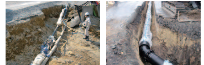
被災地にて、耐震型ダクタイル鉄管 水道管の復旧現場 (左側)は被害を受けていない
