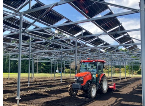
ほ場に設置された太陽光発電設備
