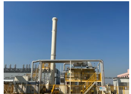
久保田発動機(無錫)有限公司(中国)では、RTO(蓄熱式脱臭装置)を導入し、VOC排出量の削減に取り組んでいます。
