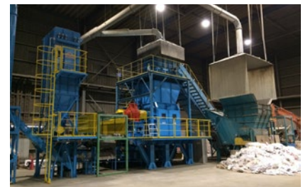
プラスチック破碎選別施設
