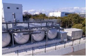
クボタ堺臨海工場 液中膜方式のFRP浄化槽
