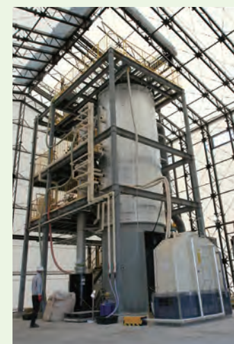
メタン発酵設備
