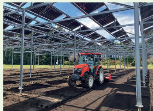
ほ場に設置された太陽光発電設備
