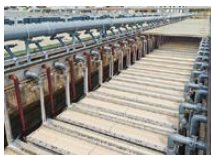
●水処理プラント
