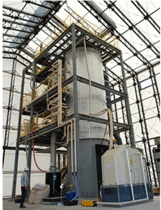
高さ約12mのメタン発酵設備
