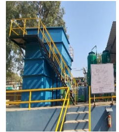
排水処理施設 (STP)
