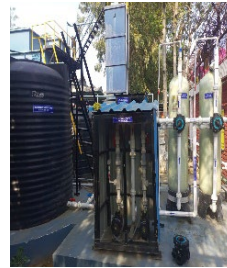
排水を再利用するための設備
