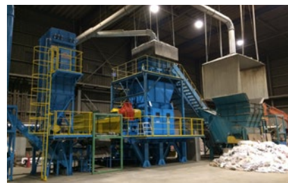
プラスチック破碎選別施設
