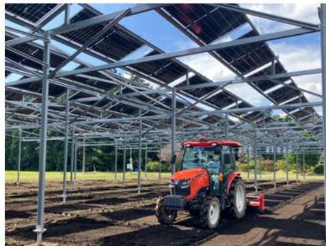
ほ場に設置された太陽光発電設備
