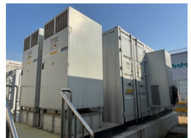
久保田農業機械（蘇州）有限公司（中国）では夏場の電力不足に備えて蓄電池を設置
