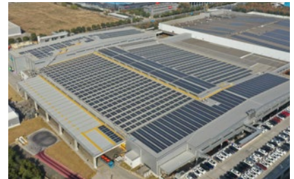
中国工場の屋根に設置した太陽光発電システム
