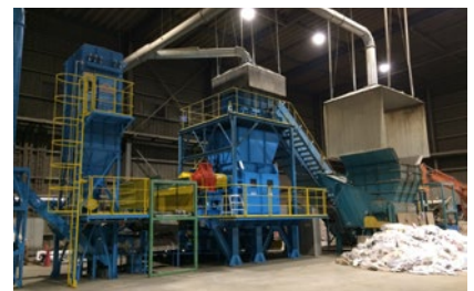
プラスチック破碎選別施設
