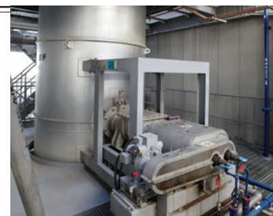
脱水汚泥（脱水ケーキ）の投入口。 1時間に2.5tが連続焼却される
