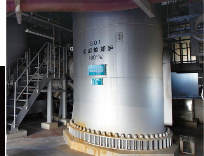
循環流動炉（基部）
