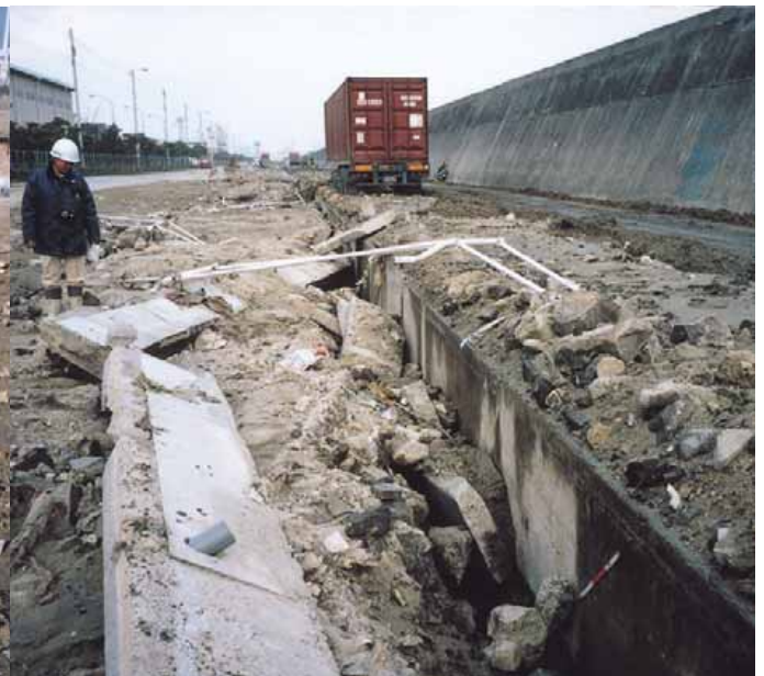
写真5-5-第1期埋立地と第2期埋立地の間の旧岸壁北側の噴礫
