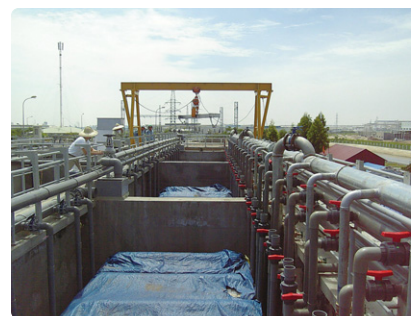
排水処理用に開発されたクボタの「液中膜」は、世界各地の排水・下水処理施設で使用されています。 (写真:液中膜が設置された工業団地の排水処理設備)
