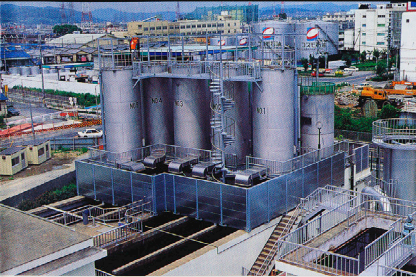
エアレーションタワー全景(高槻市水道部大冠浄水場)
