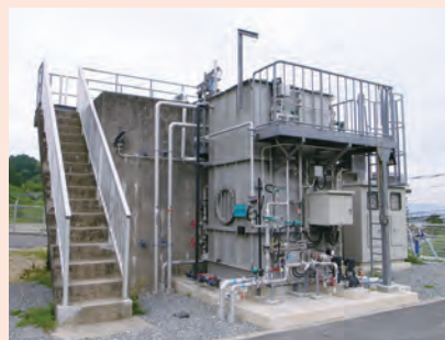
クボタフィルセラ®による排水濃縮設備
