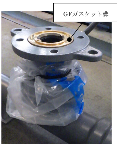
図36 補修弁のフランジ面
