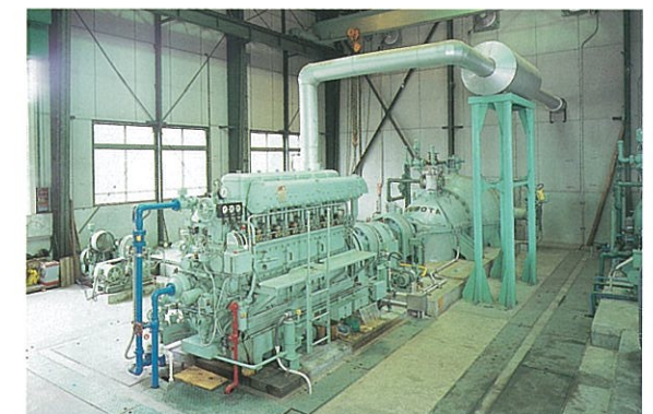
▲ポンプ場内部
