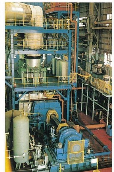
L型ガスタービンの工場運転
