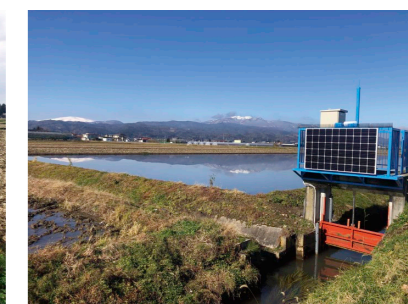
電源が取れない場所ではソーラーパネルを設置*
