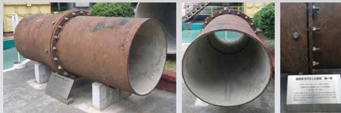
クボタ耐震型ダクタイル鉄管 第一号 布設: 1975年 場所: 八戸圏域水道企業団 掘り起し: 2013年 管種: S形
