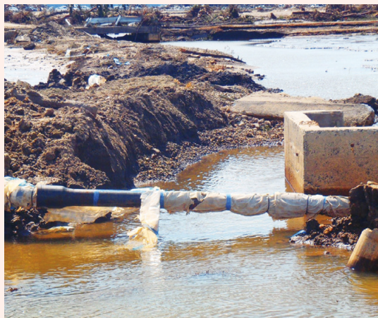
東日本大震災の津波に耐えた耐震管
