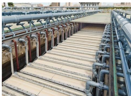
水処理プラント
