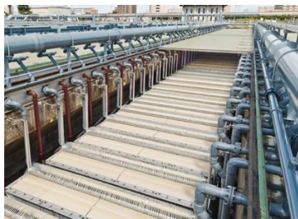
水処理プラント
