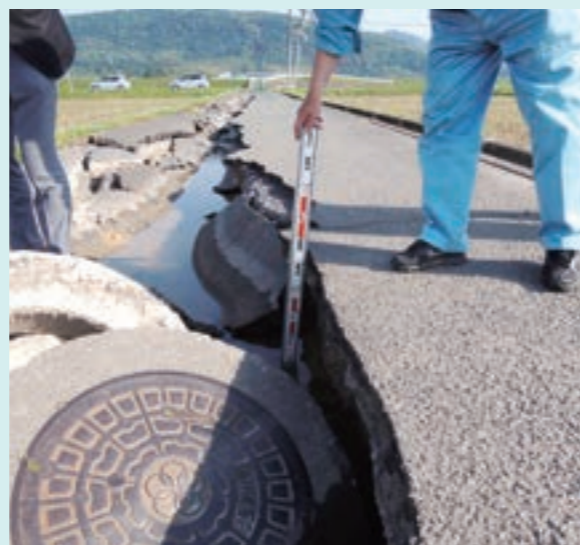
被害調査の現場 集めたデータをもとに復興へ役立てます
