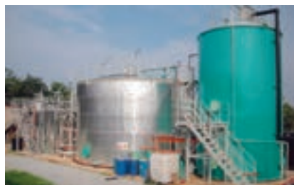
マレーシアの実証設備
