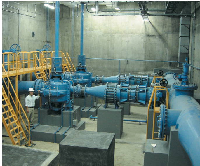
現地に設置された当社ポンプ設備
