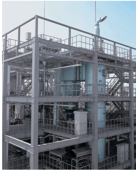
●循環流動焼却炉
