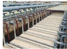
●水処理プラント
