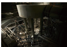
香川県産業廃棄物 中間処理施設が稼働
