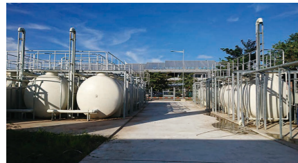
●浄化槽 下水道が整備されていない地域の排水処理を行います。
